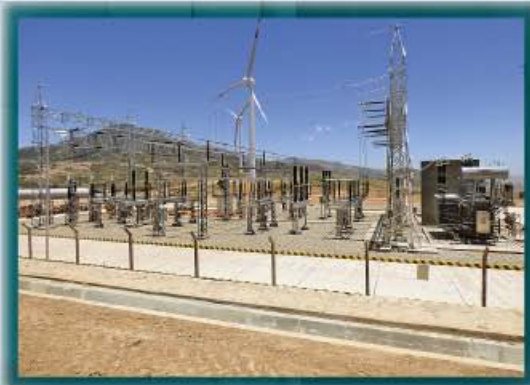
Subestación Qollpana Parque Eólico
