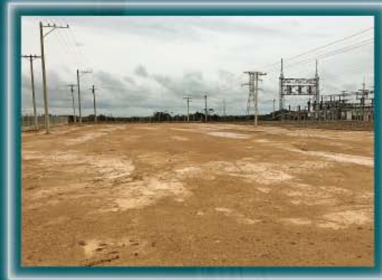
Equipo Transformador de 25 MVA y Bahía de Transformación Trinidad (ENDE)
