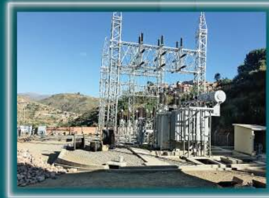
Línea de Transmisión y Subestación T12 (CESSA)
