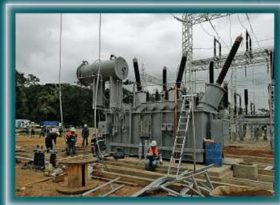
Bahía 230 kV y Transformador de Potencia en Subestación Carrasco
