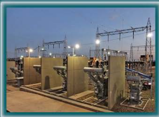
Segunda Fase Línea de Transmisión 230kV Chaco – Tarija
