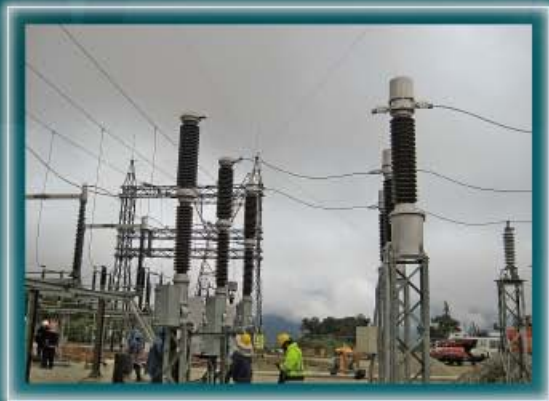
Bahía de Transformador 115 kV – San José
