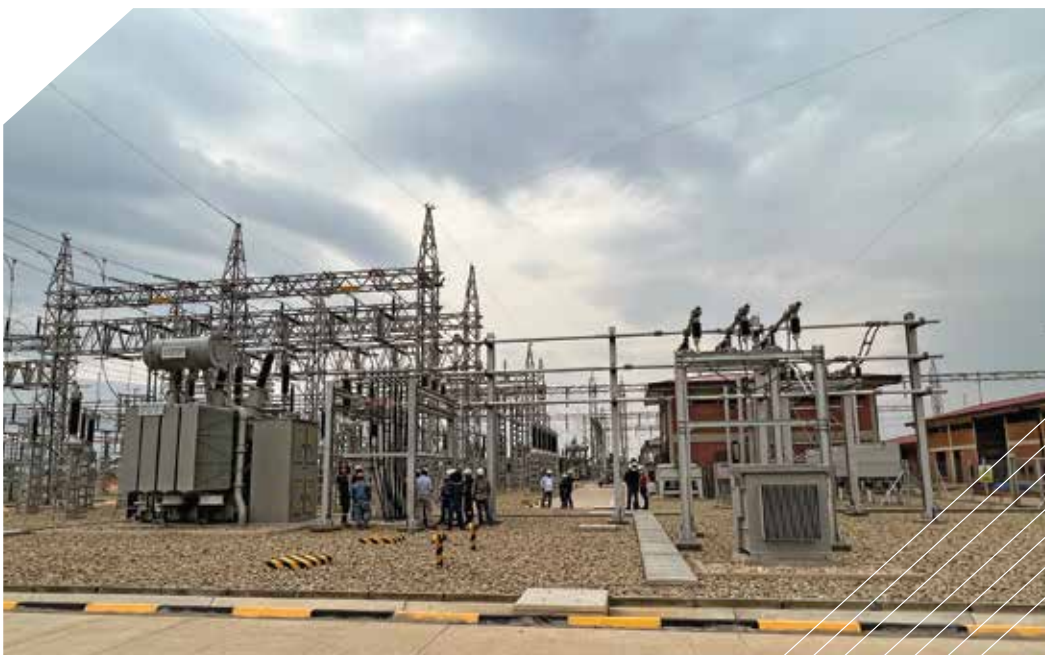
Subestación Paraíso 230/115 kV. Foto: Archivo ENDE Transmisión
