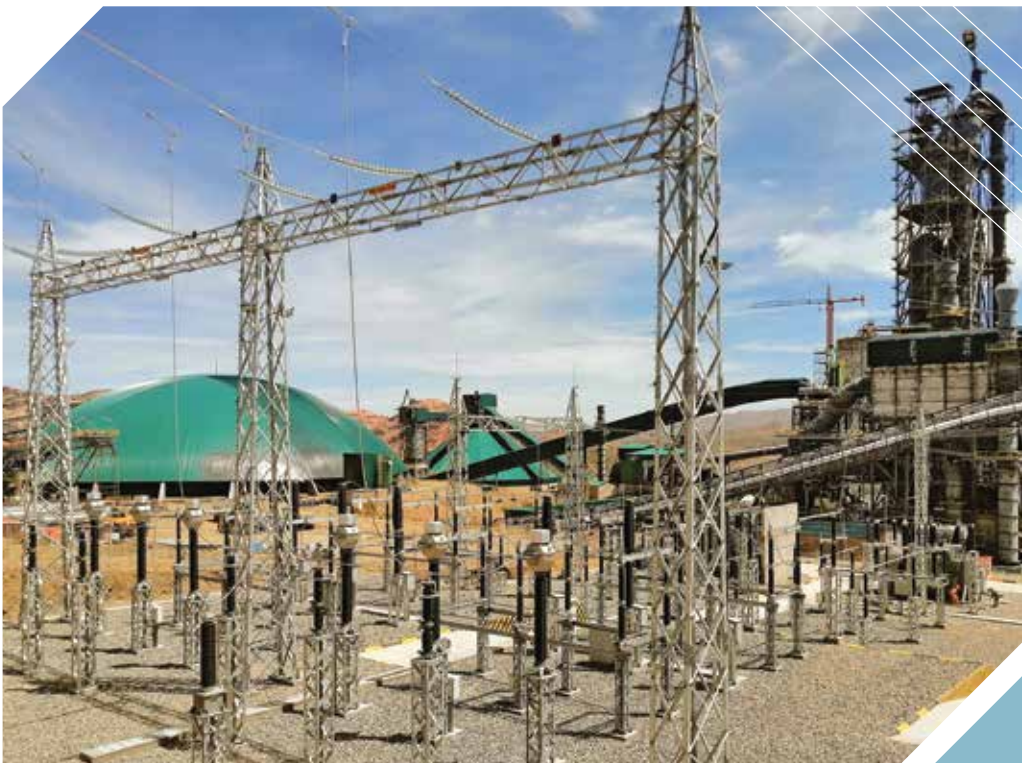
Subestación 115 kV ECEBOL, Potosí Categoría: Técnica Foto: Marco Antonio Mamani
