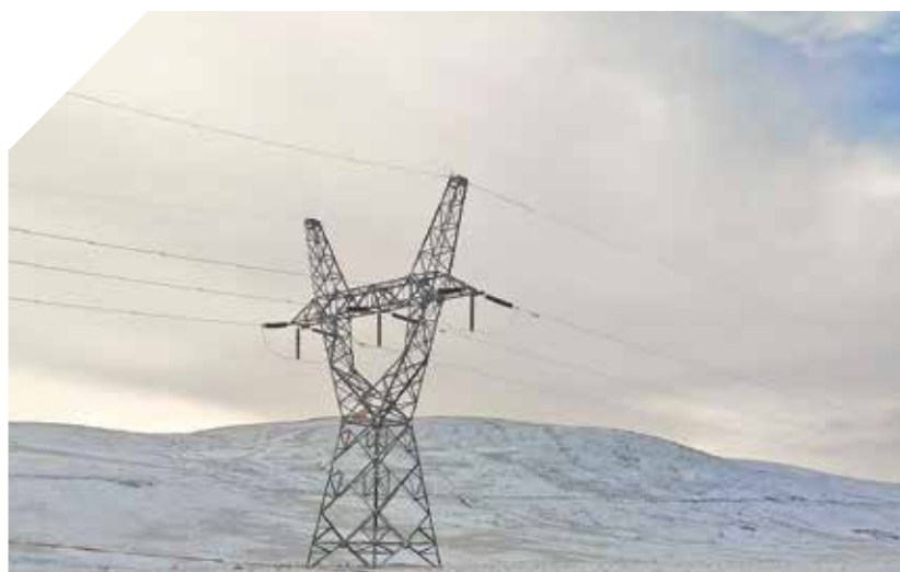
Línea 115 kV Catavi - Potosí (Tramo Ocuri - Potosí), Potosí Categoría: Técnica Foto: Marco Antonio Mamani
