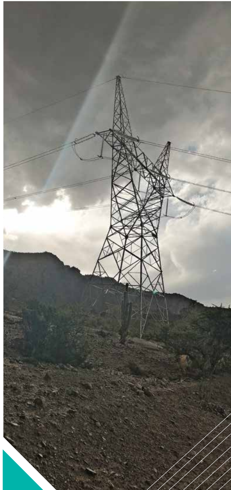
Torre 230 kV ingreso a Subestación Torrehuayco, Potosí Categoría: Técnica Foto: Angela Campos
