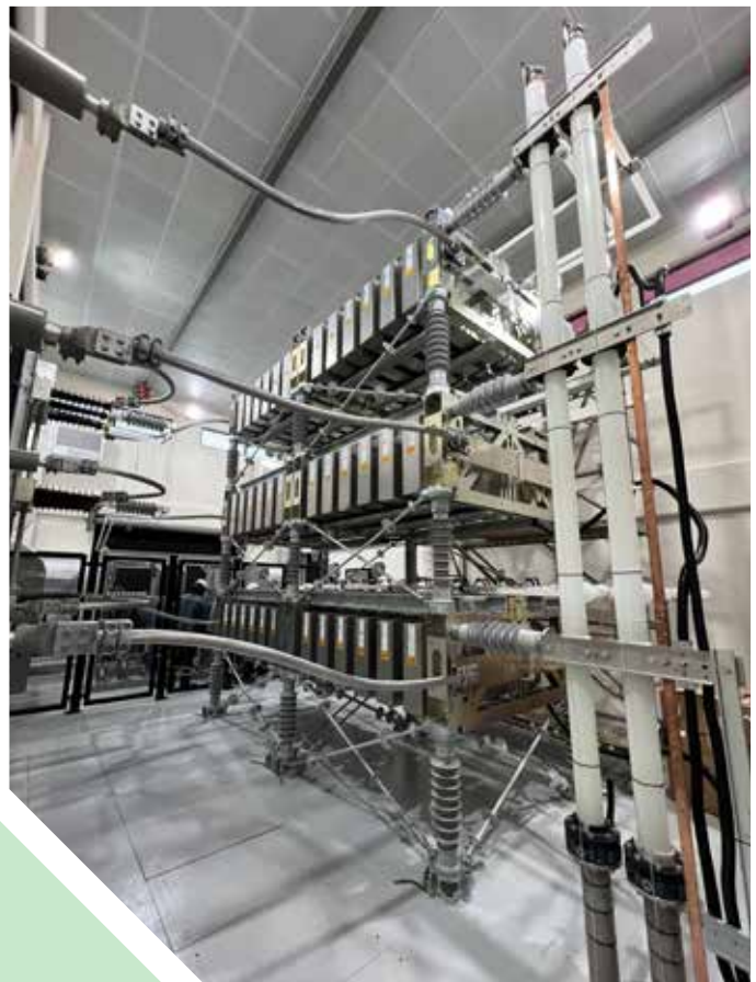
Statcom 115 kV Foto: Archivo ENDE Transmisión
