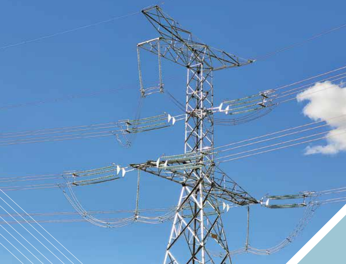
Estructura de anclaje, Línea 500 kV Carrasco - Santivañez, Cochabamba. Categoría: Técnica Foto: Jorge Pinto
