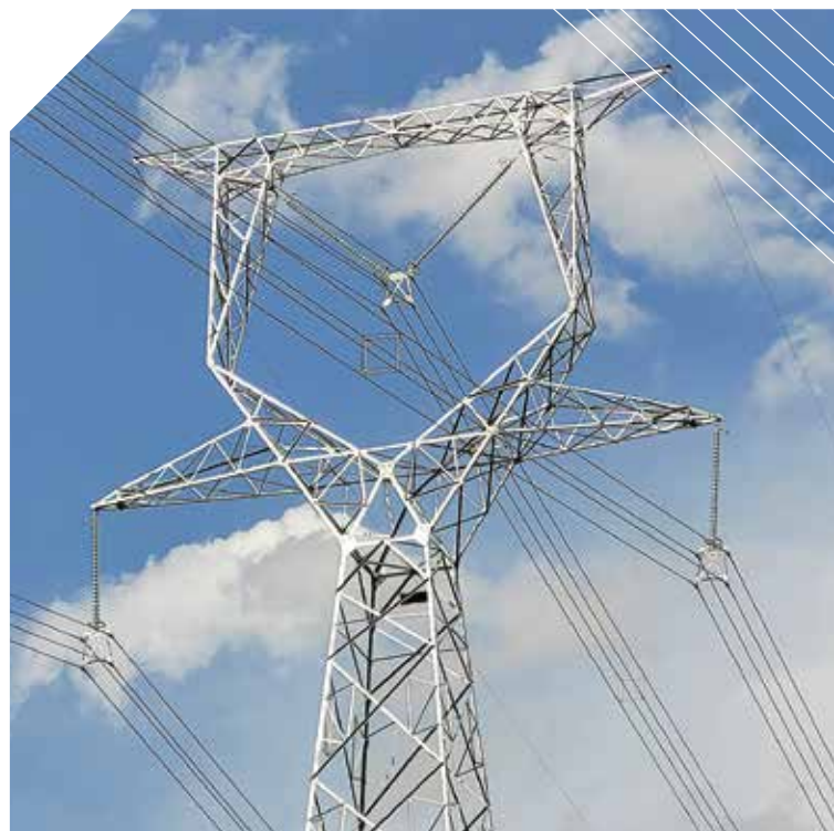
Estructuras de suspensión, Línea 500 kV Carrasco - Santivañez, Cochabamba Categoría: Técnica Foto: Jorge Pinto
