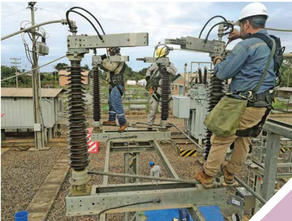
Trabajos en Subestación San Borja 115 kV, Beni Categoría: Personal Foto: Joel Atahuichi
