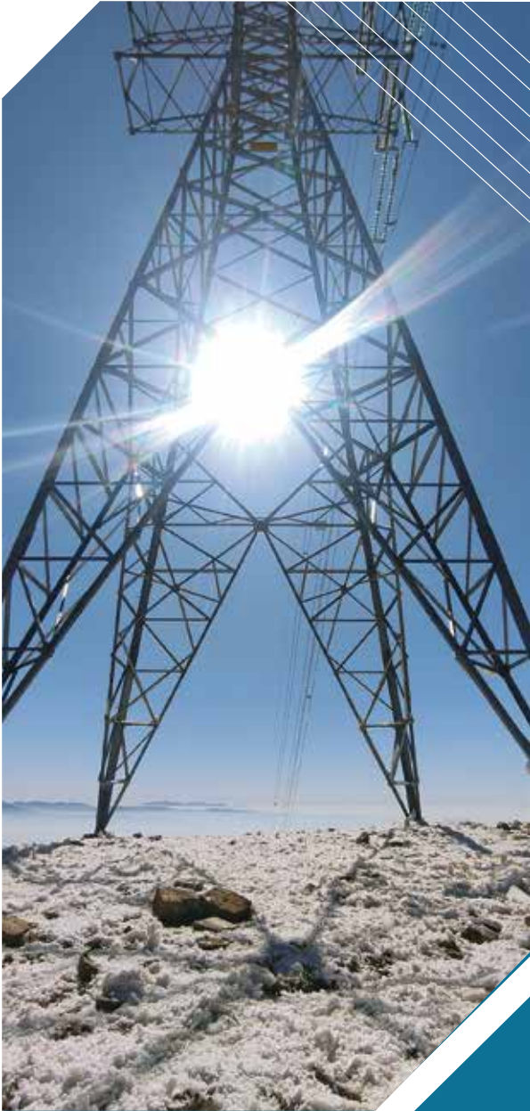
Línea 230 kV Las Carreras - Tarija. Túnel Falda de la Queñua Categoría: Técnica Foto: Humberto Villegas
