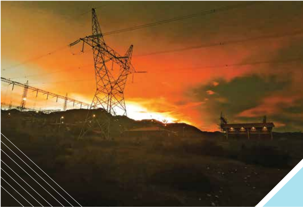
Subestación Torrehuayco 230/69 kV. Tupiza - Potosí Categoría: Técnica Foto: Angela Campos
