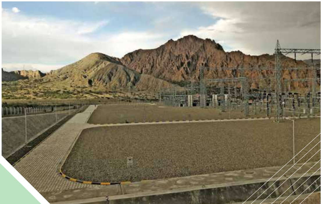
Subestación Torrehuayco 230/69 kV. Tupiza - Potosí Categoría: Técnica Foto: Angela Campos
