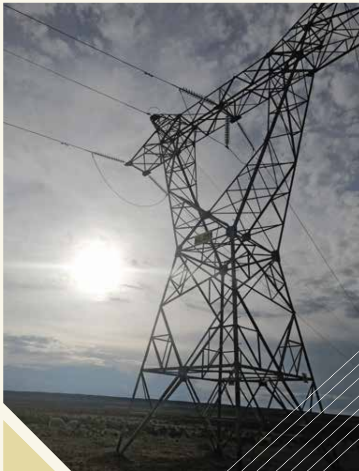
Línea 115 kV Litio - Salar, Localidad San Cristóbal, Potosí Categoría; Técnica Foto: Marco Antonio Mamani
