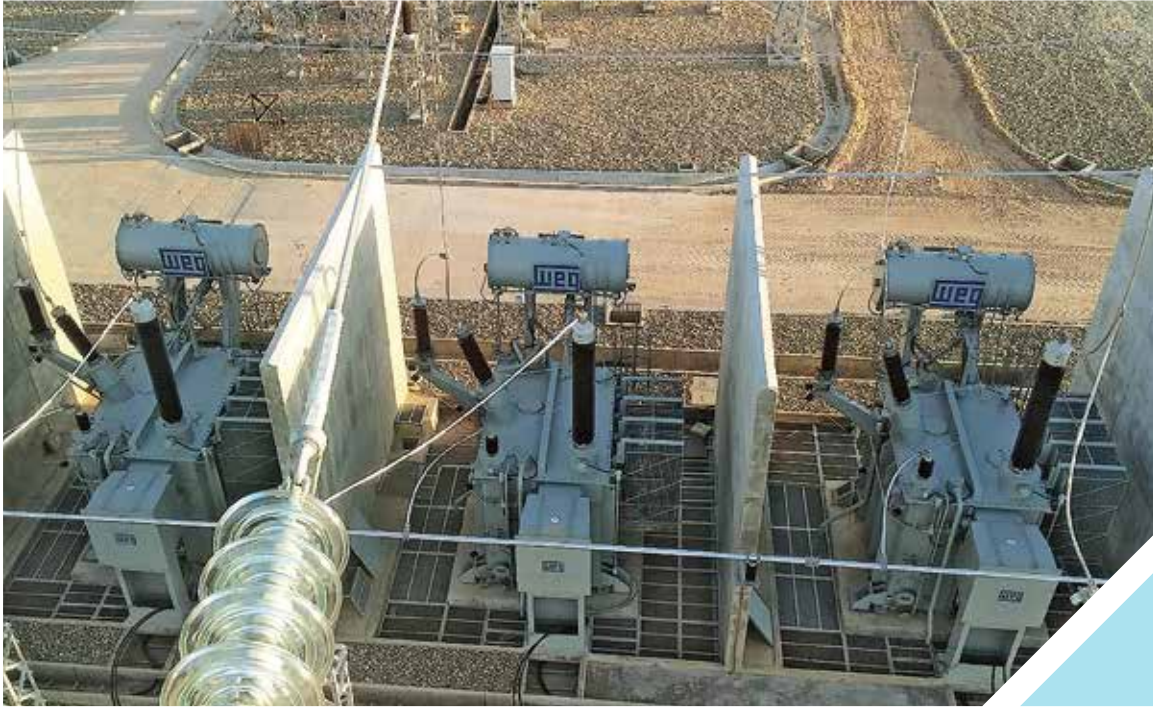
Subestación La Bélgica 230/115 kV Foto: Archivo ENDE Transmisión
