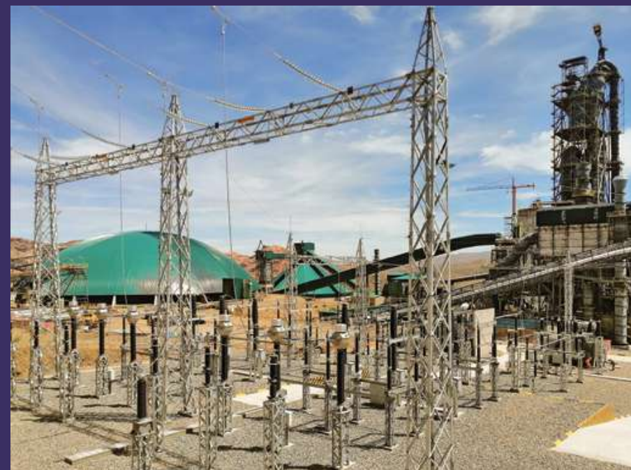
Subestación 115 kV ECEBOL, Potosí Foto: Marco Antonio Mamani
