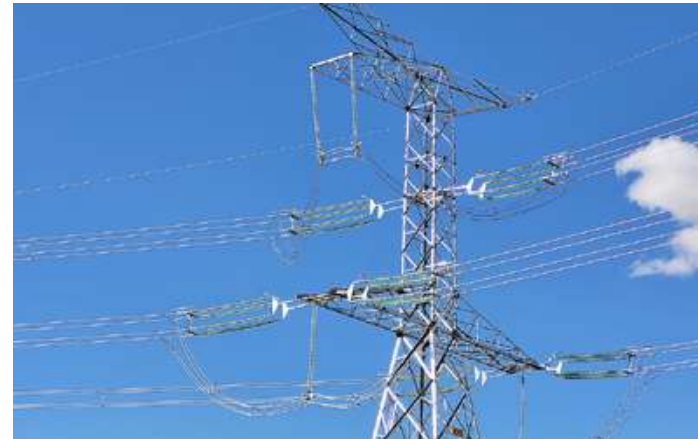
Estructura de anclaje, Línea 500 kV Carrasco - Santivañez, Cochabamba. Foto: Jorge Pinto
