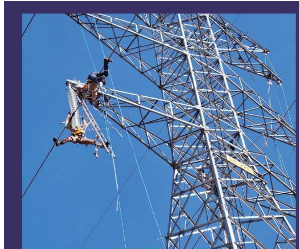
Variante 226, Línea 230 kV Santivañez - La Palca. Cochabamba - La Paz Foto: Ramiro Vargas
