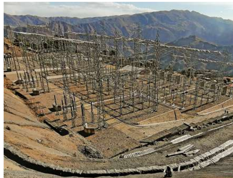
Subestación La Palca 230 kV, Tuhuaco - La Paz Foto: Angela Campos
