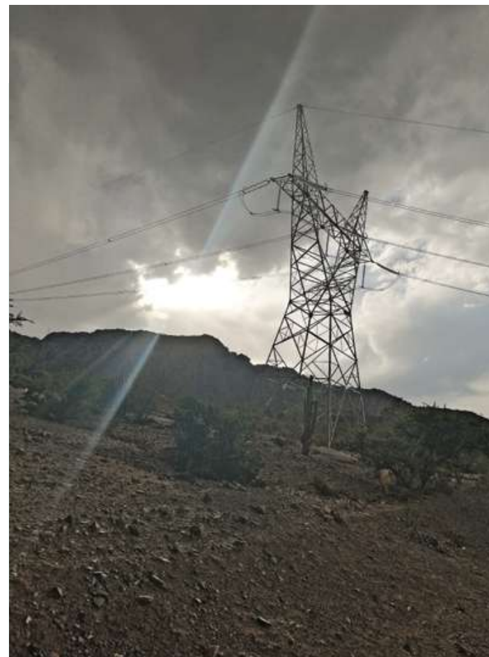
Torre 230 kV ingreso a Subestación, Torrehuayco, Potosí Foto: Angela Campos
