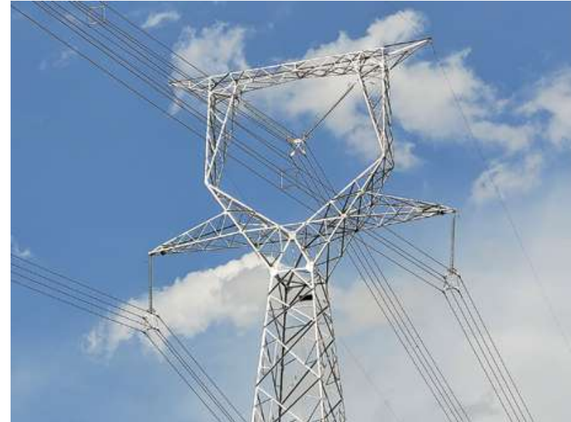
Línea 115 kV Catavi - Potosí (Tramo Ocuri - Potosí), Potosí Foto: Marco Antonio Mamani
