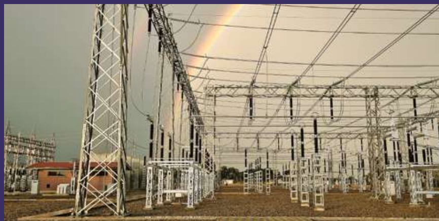
Subestación Paraíso 230/115 kV, Beni Foto: Joel Atahuichi
