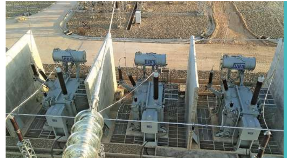
Subestación La Bélgica 230/115 kV Foto: Archivo ENDE Transmisión
