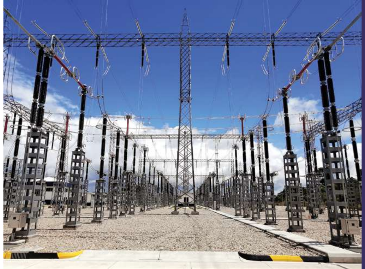
Subestación Carrasco 500 kV - Cochabamba Foto: Gustavo Torrico
