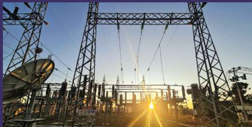
Amanecer en Subestación Aranjuez 69 kV, Sucre Foto: Daniel Caballero
