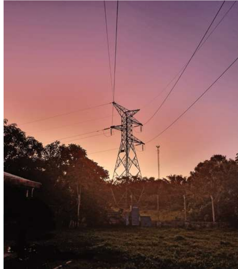
Línea 115 kV San Ignacio de Moxos - San Borja, Beni Foto: Joel Atahuichi
