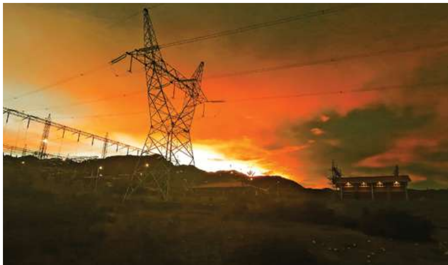
Subestación Torrehuayco 230/69 kV. Tupiza - Potosí Foto: Angela Campos
