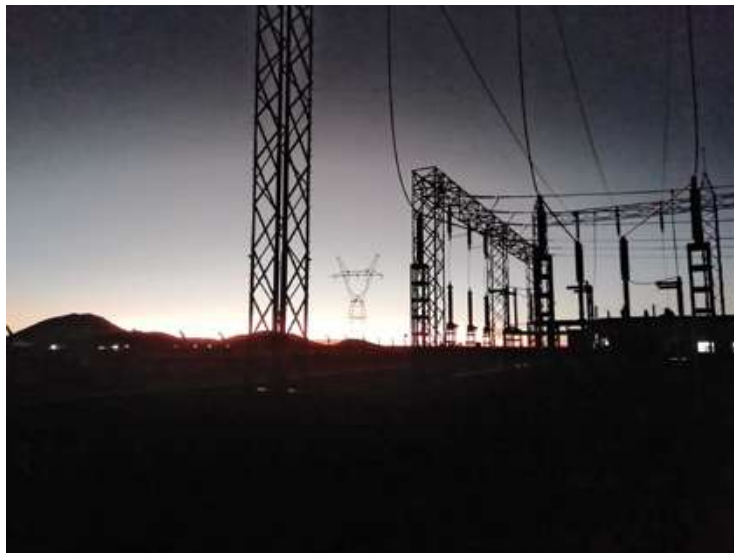
Atardecer Subestacion Planta Solar La Joya. Foto: José Luis Claros
