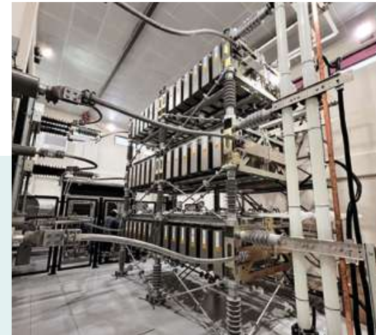
Statcom 115 kV Foto: Archivo ENDE Transmisión
