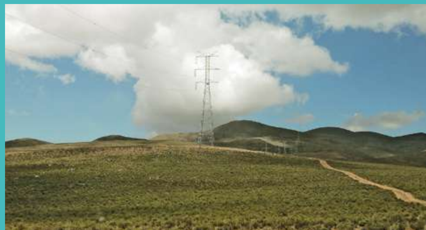
Estructura de anclaje, Línea 500 kV Carrasco - Santivañez, Cochabamba. Foto: Jorge Pinto
