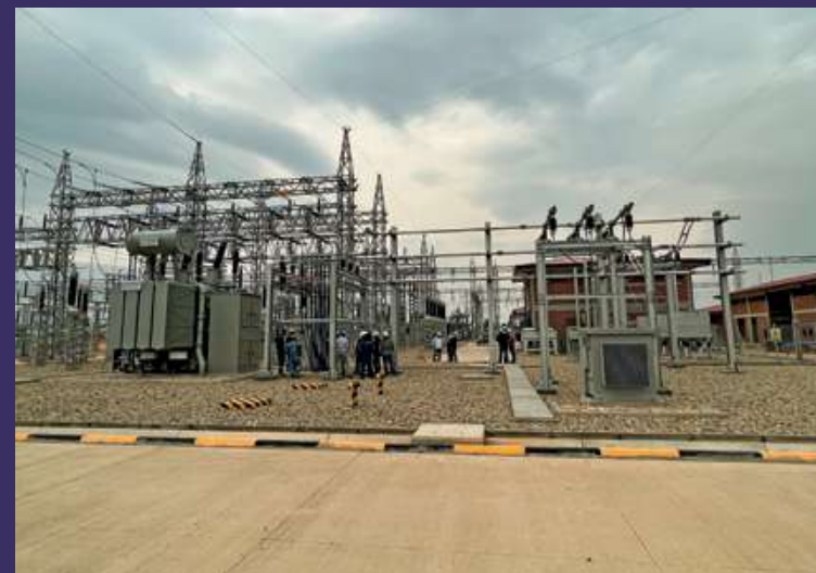
Subestación Paraíso 230/115 kV. Foto: Archivo ENDE Transmisión
