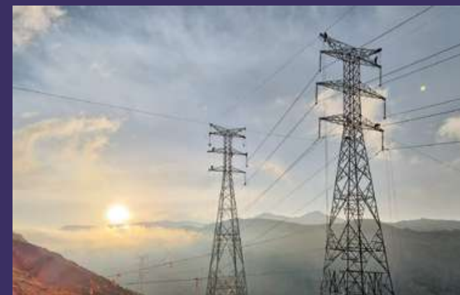
Variante 226 - Línea 230 kV Santivañez - La Palca, Cochabamba - La Paz. Foto: Ramiro Vargas
