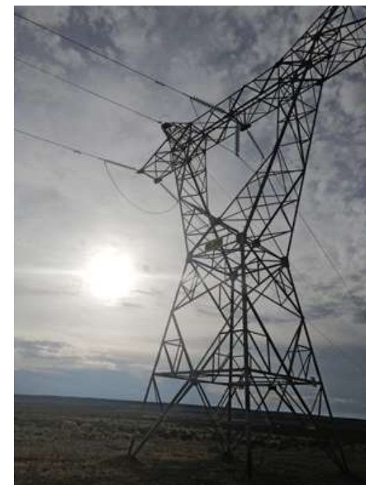
Línea 115 kV Litio - Salar, Localidad San Cristóbal, Potosí Foto: Marco Antonio Mamani
